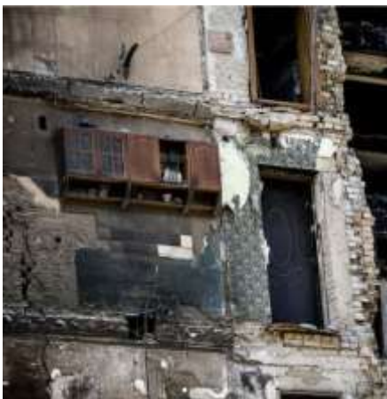
Фото 12. Стіна зруйнованого будинку в Бородянці, на якій висить кухонна шафа з глиняною скульптурою півня зверху (автор – Єлизавета Серватинська ).
