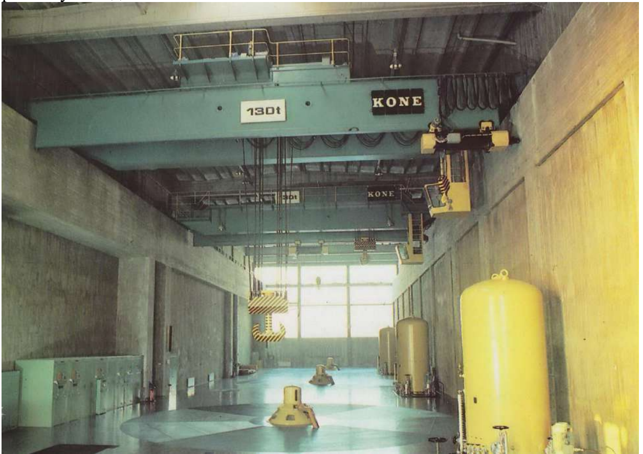
Рисунок 3.10 – Монтажні мостові крани в машзалі ГЕС
