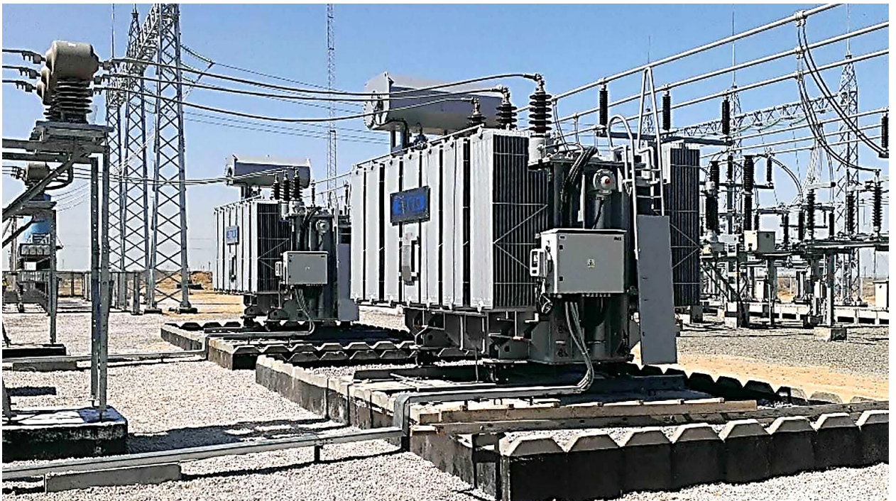
Рисунок 1.2 – Керований підмагнічуванням реактор на базі РТУ-100000/10 виробництва ETD TRANSFORMATORY [29, 30]
