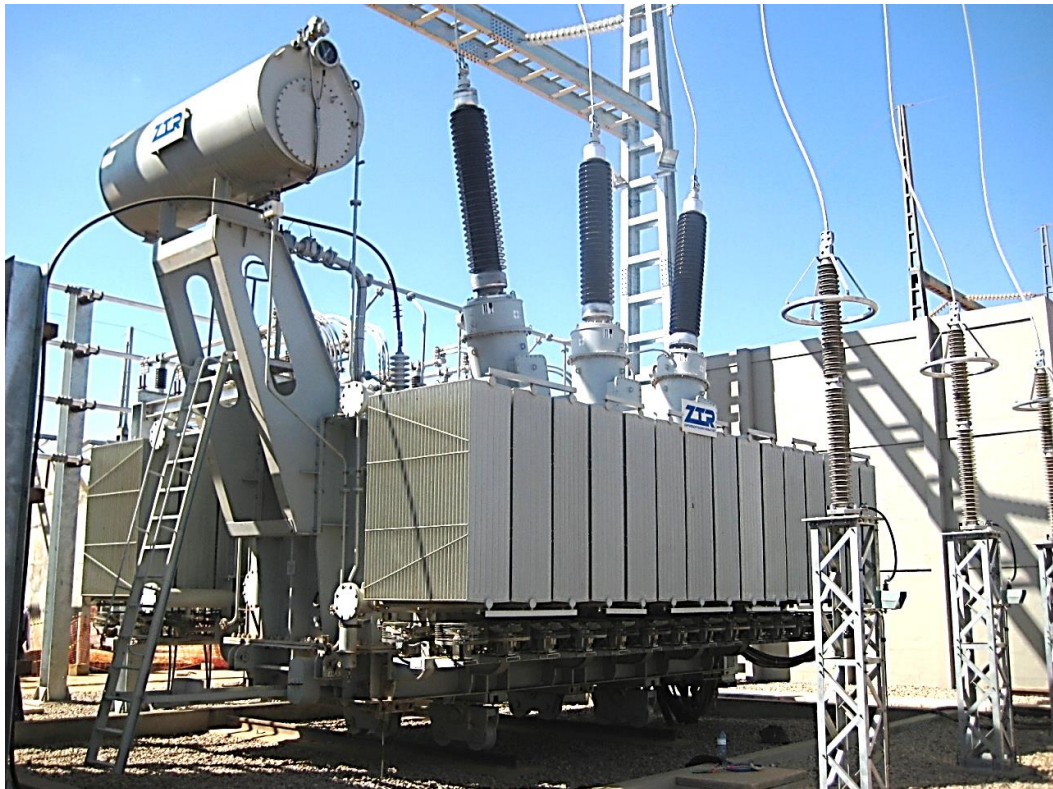
Рисунок 1.8 – Керований підмагнічуванням реактор трансформаторного типу виробництва ВАТ «Запоріжтрансформатор» [29]
