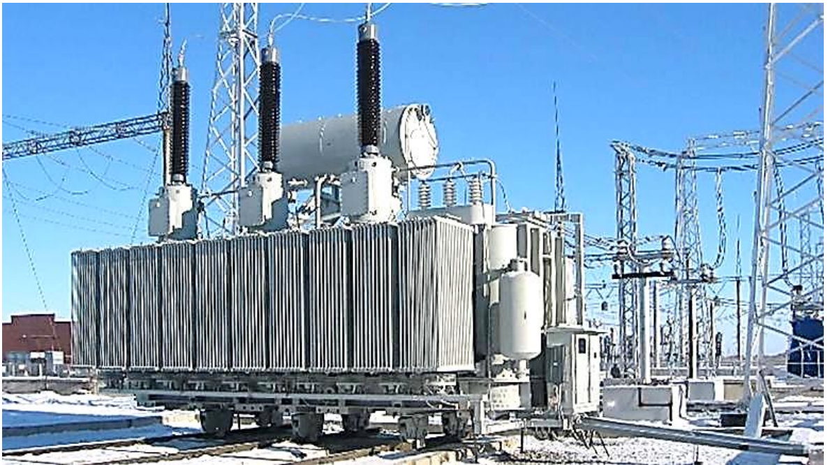
Рисунок 1.1 – Керований підмагнічуванням реактор на базі РТУ-100000/220 виробництва ВАТ «Запоріжтрансформатор» [29, 30]
