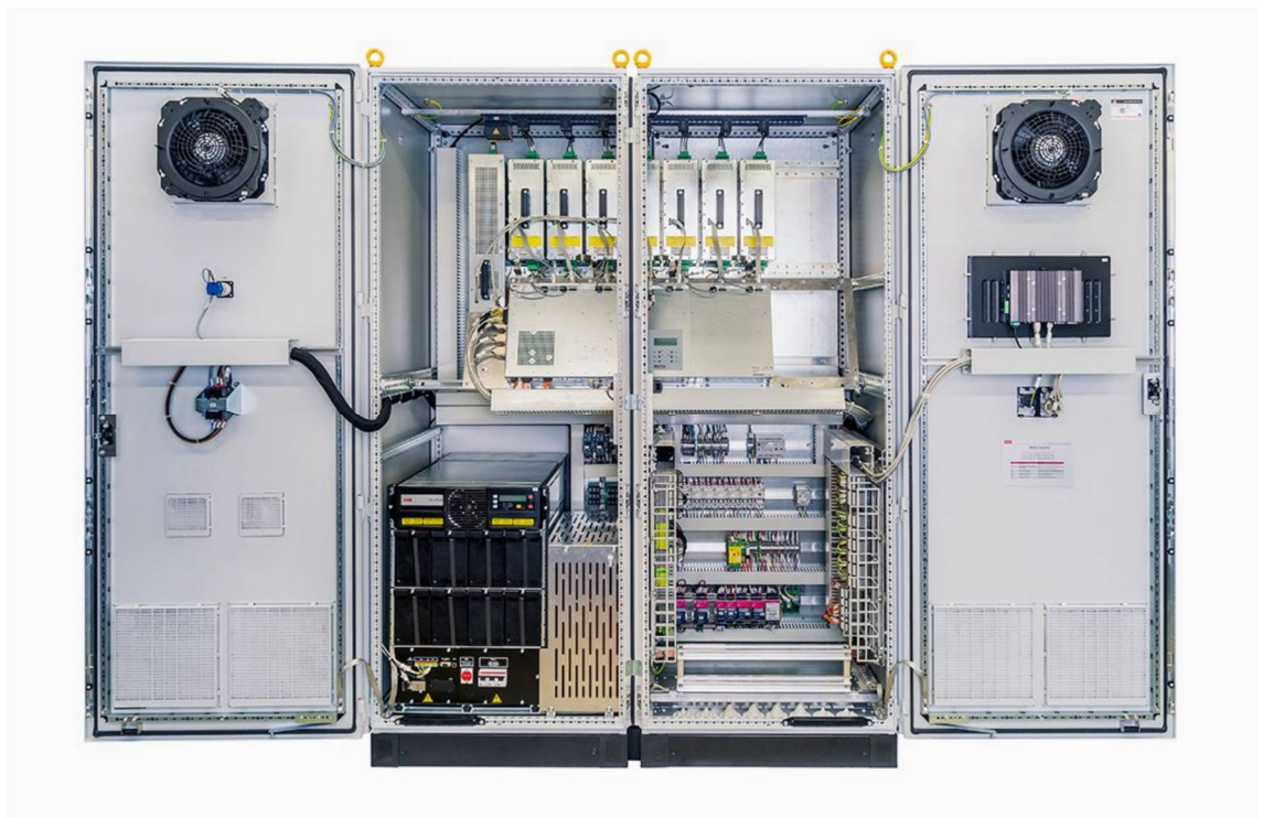
Рисунок 1.1 – Загальний вигляд шафи
