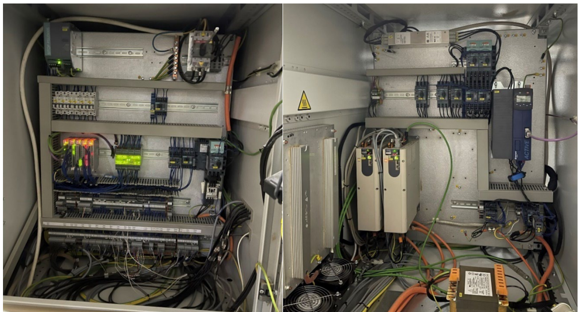
Рисунок 2.3 - Внутрішня конструкція електронно-комутаційної шафи Biesse Rover a 1632 на підприємстві
