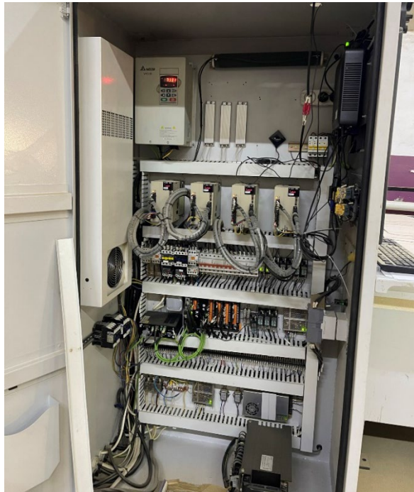
Рисунок 2.2 – Внутрішня конструкція електронно-комутаційної шафи KDT KS-828C на підприємстві
