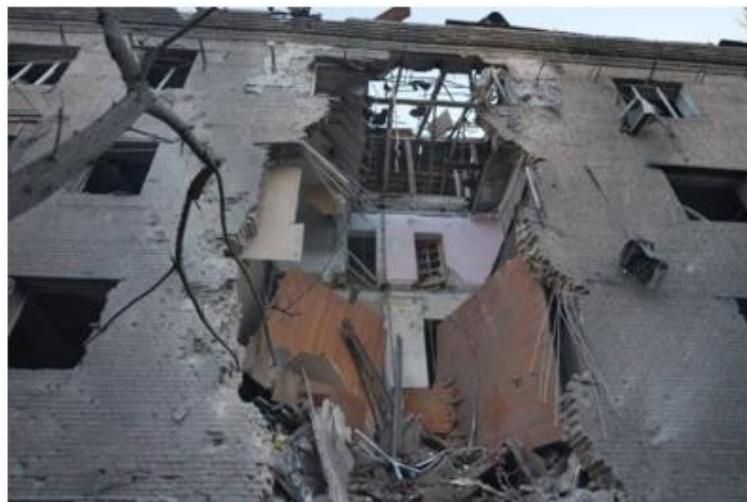
Рисунок 2.7 Фасад багатоповерхівки, зруйнованої під час авіаційних ударів по м.Запоріжжя 29 вересня 2024року
