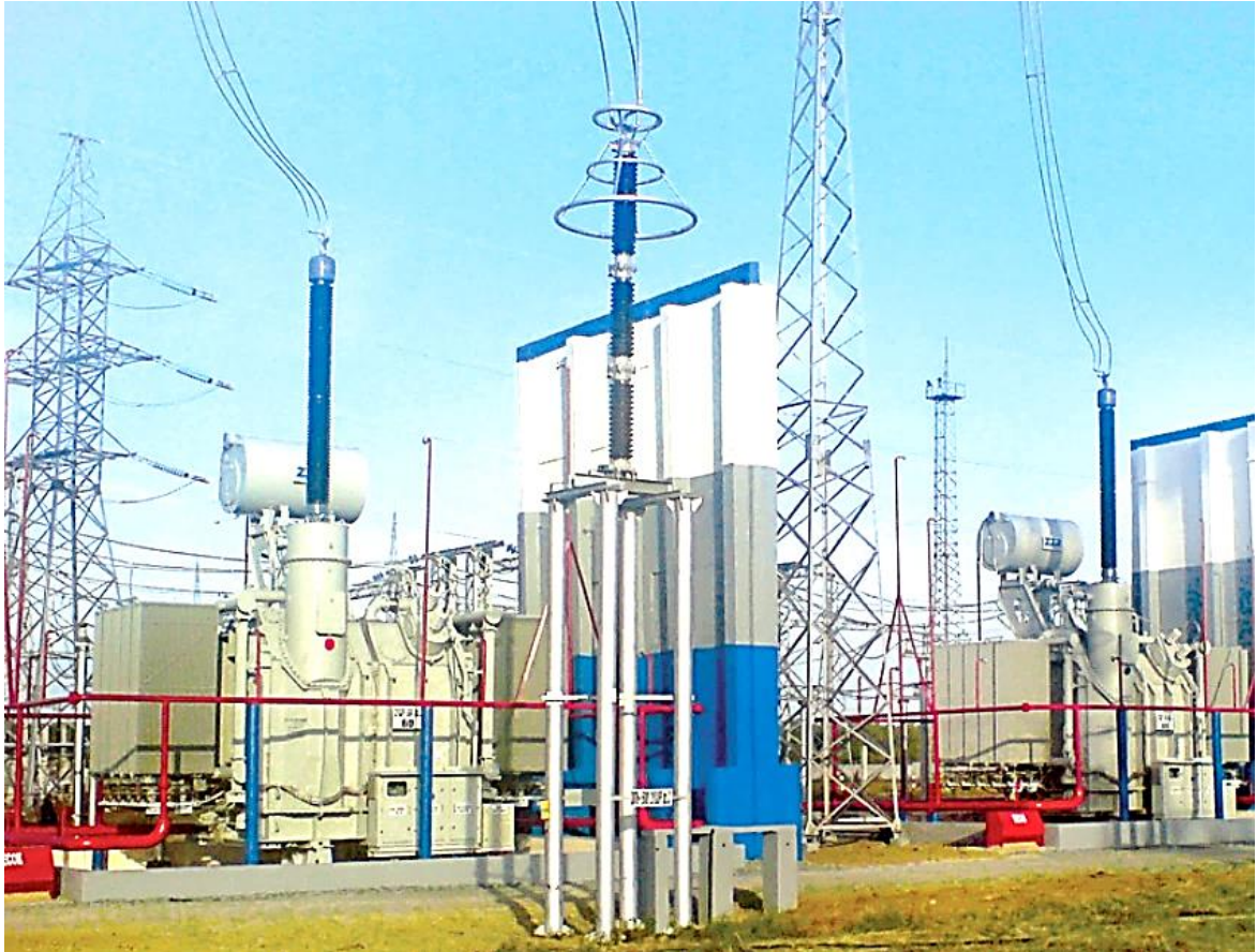
Рисунок 2.5 – РТУ-180000/500 комплексу КПШР, що складається з трьох реакторів РОДУ 60000/500, виробництва ПрАТ «Запоріжтрансформатор»
