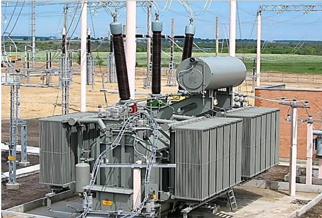
Рисунок 2.1 – Керований підмагнічуванням реактор виробництва ПрАТ «Запоріжтрансформатор» [29]
