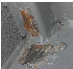
Рисунок 1 – Зона дослідження корозії в металевій конструкції
