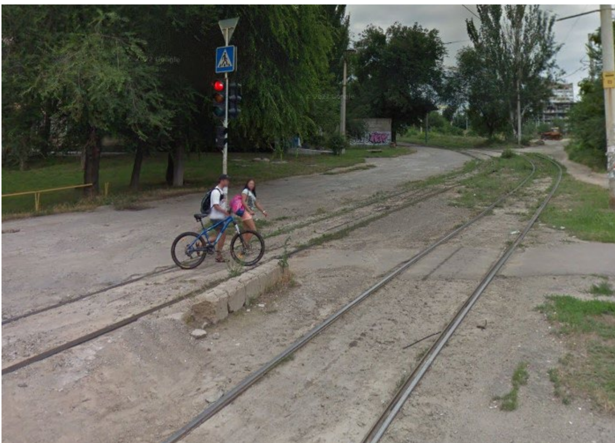
Рисунок 1.12 – Приклад поганого стану пішохідного переходу через трамвайні колії по вулиці Шкільній
