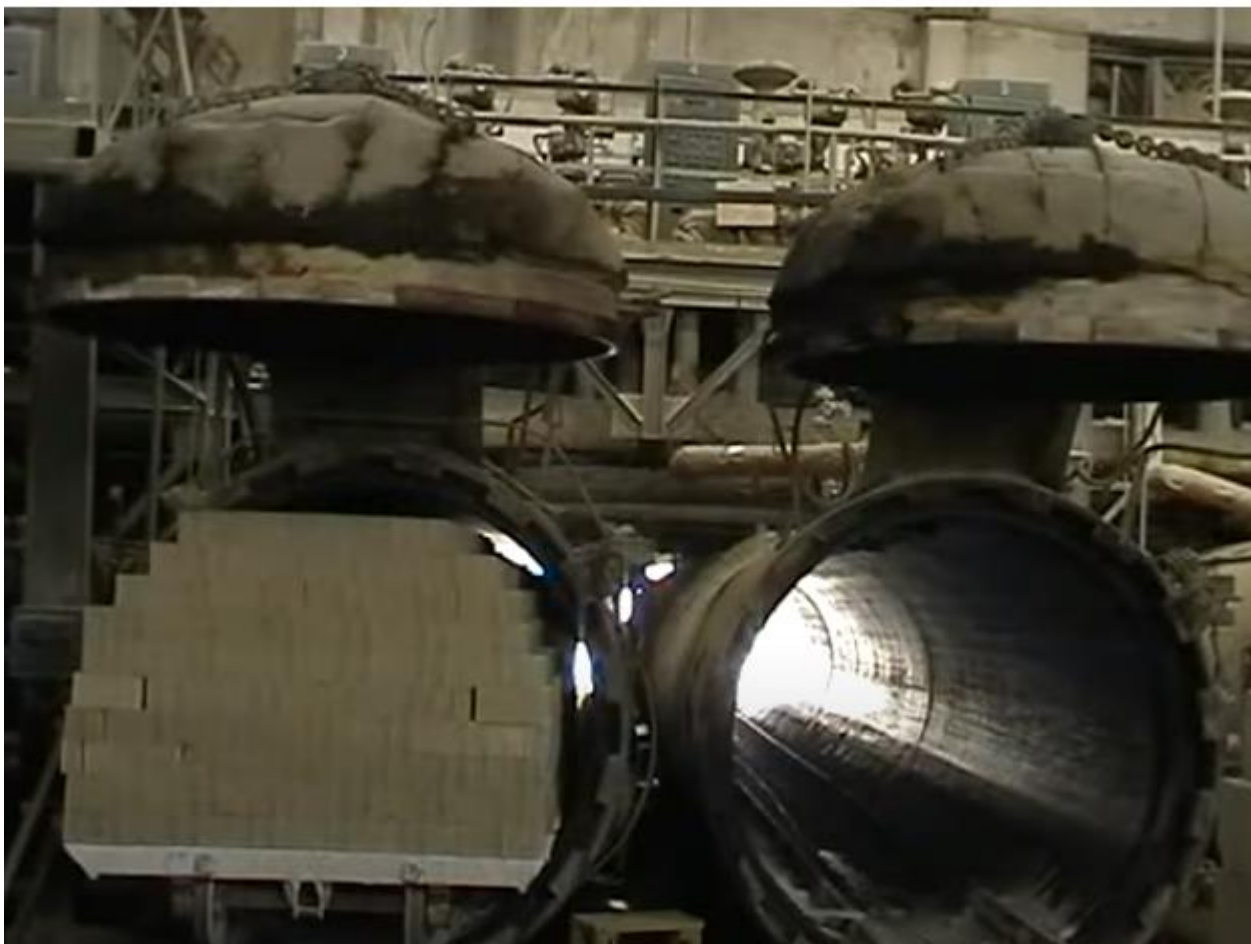
Рисунок 1.6 – Загальний вигляд автоклавів
