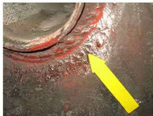
Тріщина в ущільнювальному шві труби котла до парового барабана виявлена за допомогою МТ. Це було результатом неправильних процедур ремонту.
