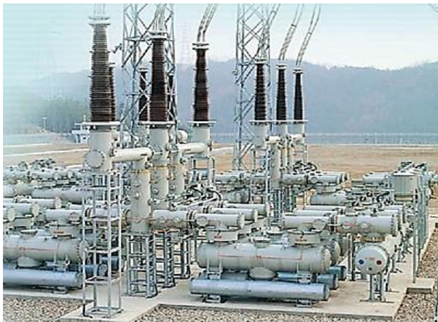
Рисунок 11.10 – Вид загальний комірки КРУЕ повітряного вводу типу 362 SL/SR/SU КРУЕ 362 кВ трифазного виконання виробництва Hyundai Heavy Industries [118, 119, 121]
