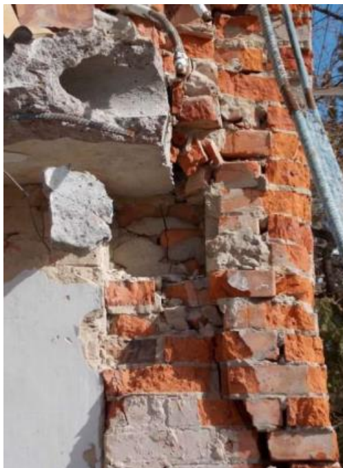
Рисунок 5.2 – Пошкодження цегляного мурування при руйнуванні
