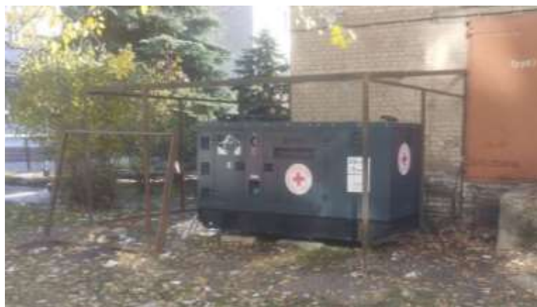
Рисунок 1.5 – Малий резервний генератор
