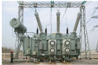
Рисунок 1.26 - Зовнішній вигляд потужного трансформатора з масляним охолодженням типової потужності 63МВА
