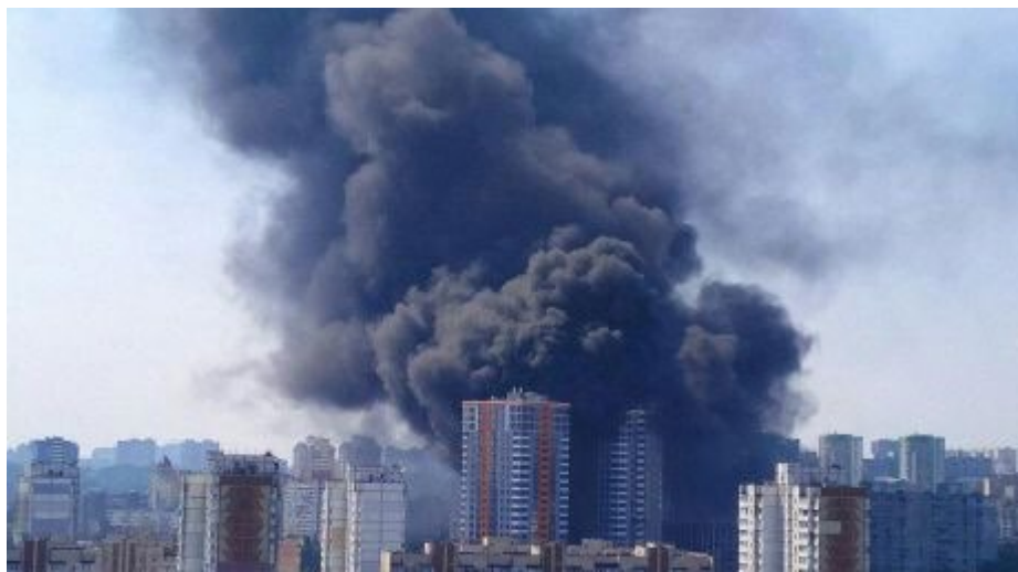
Рисунок 5.2 – Наслідки виникнення пожежі на будівництві
