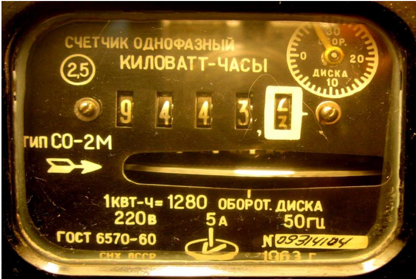
Рисунок 2.5 – Лічильник витрат електроенергії СО-2М
