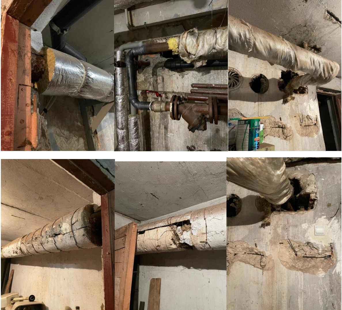
Рисунок 1.18 – Стара ізоляція труб
