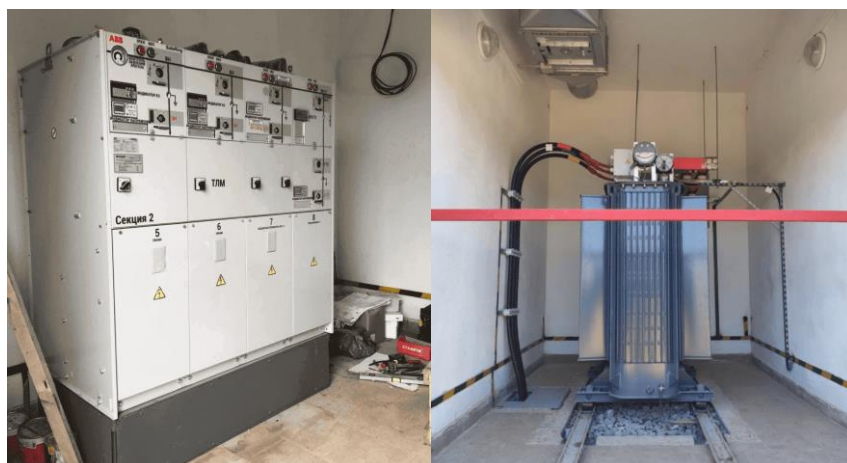
Рисунок 4.2 – Приміщення де встановлюються частини підстанції
