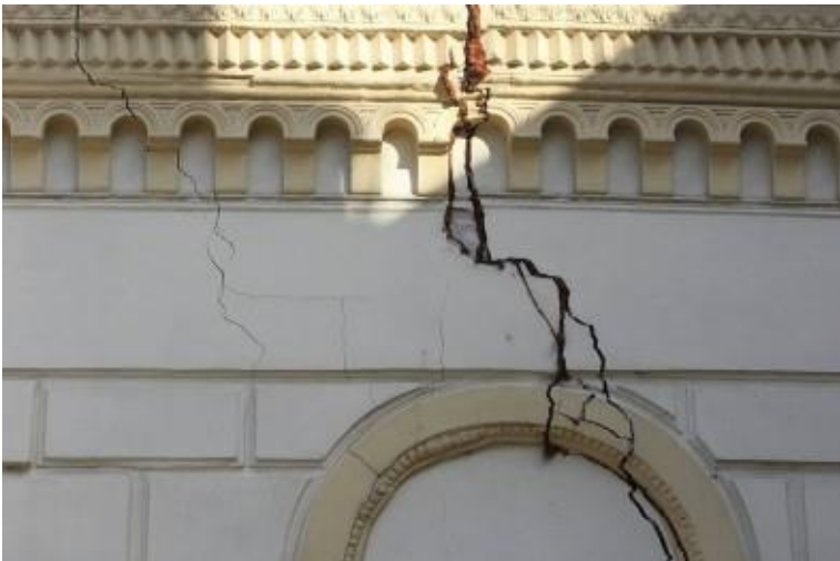
Рисунок 3.3 – Фіксація тріщин на стіні
