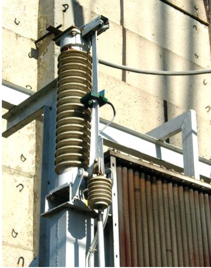
Рисунок 2.1 – Вимірювання ЧР на заземленні нейтралі трансформатора
