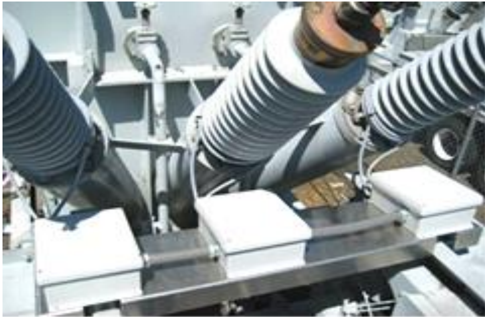
Рисунок 1.2 – Високовольтні вводи силового трансформатора
