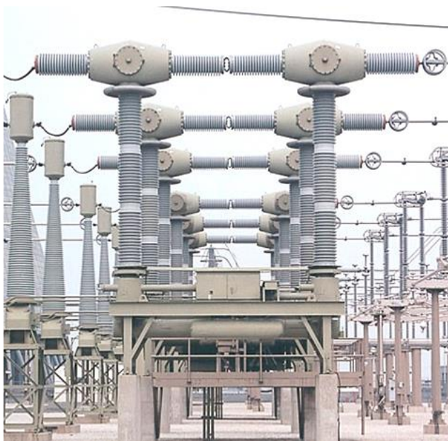
Рисунок 6.2 – Повітряні вимикачі на атомній електростанції Salem (США)
