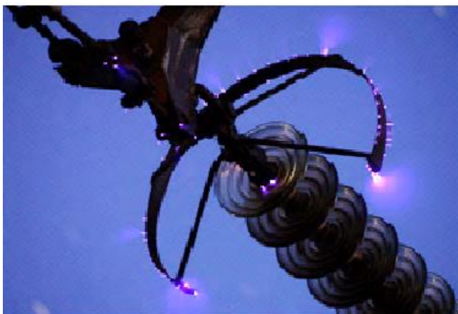
Рисунок 5.2 – Коронний розряд на екрані(на захисному кільці) високовольтної повітряної лінії електропередачі напругою 500 кВ
