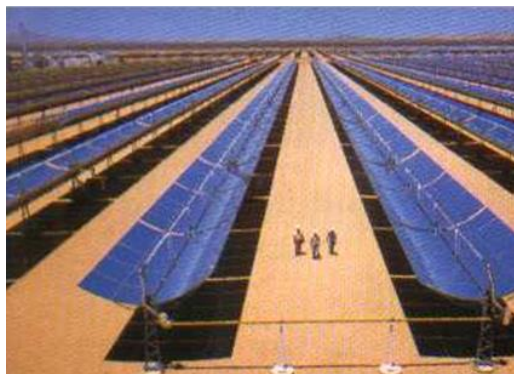
Рис. 3.11 – Електростанція в Каліфорнії
