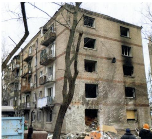
Рисунок 2.10 – Стан будівлі після обстрілу
