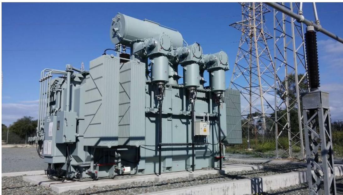
Рисунок 1.2 – Шунтувальний реактор виробництва Siemens
