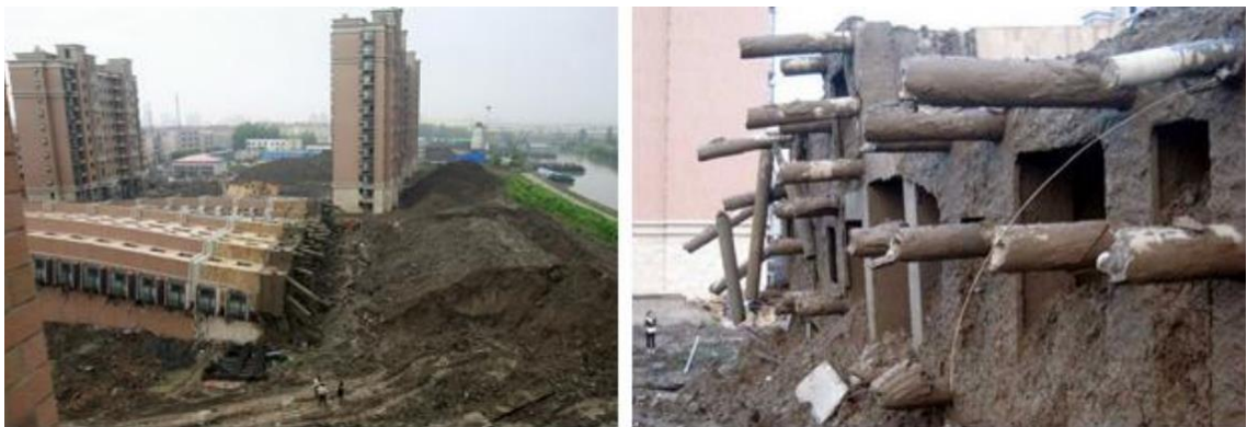
Рисунок 6.2 – У Шанхаї стався обвал 13-поверхового житлового будинку через провал збірних пустотілих залізобетонних палів
